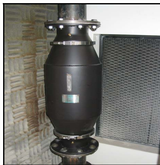
Imagen 5. Filtro DPF DCL Instalado en Grupo Electrónico de 500 KVA.
