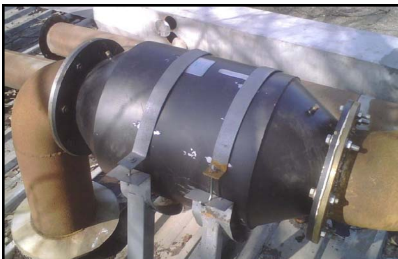
Imagen 2. Filtro DPF DCL Instalado en Grupo Electrónico de 500 KVA.
